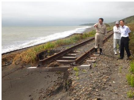
高潮で線路と路盤が消失した JR 日高線清島の海岸線を調査する畠山衆議。右端は真壁町議。
