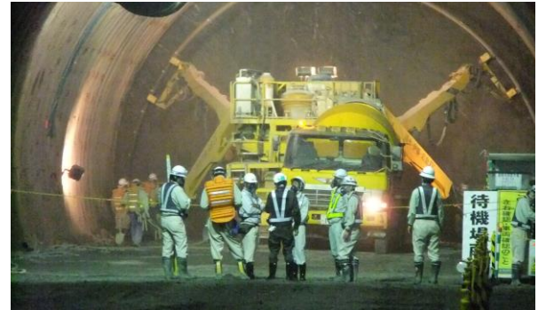
掘削中のトンネル坑内で作業を見守る紙議員（中央こちら向き）＝7日、中川町
