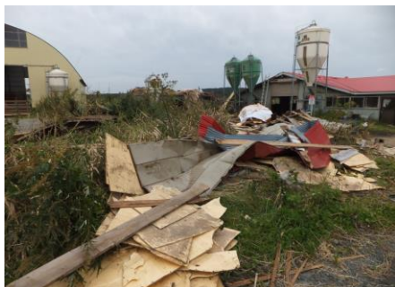
突風で吹き飛んだ牛舎の屋根・厚岸町
