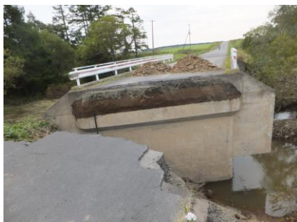
大雨で決壊した橋と町道・浜中町
